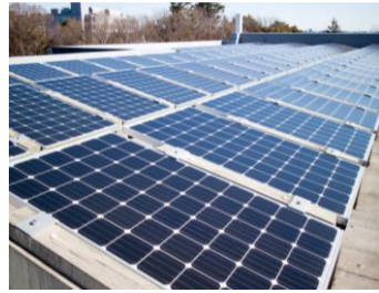
本館屋上に設置されている太陽電池パネル
