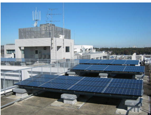
東4号館屋上太陽光発電設備
