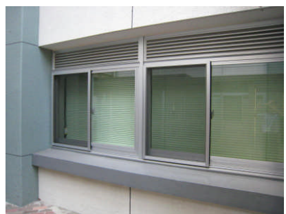
窓に複層ガラスを採用
