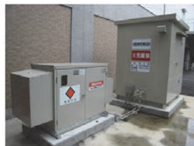
自家発電設備
