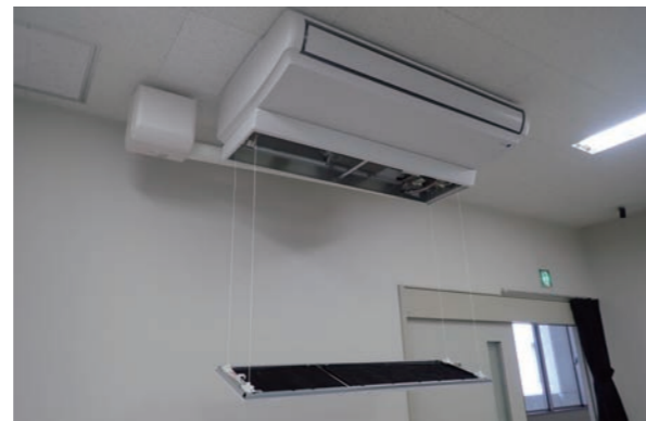
【写真2】電動昇降式の室内パネル
