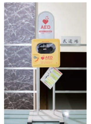
【写真】体育館内に設置されている AED
