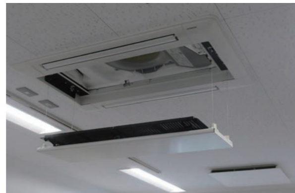
【写真2】電動昇降式の室内パネル
